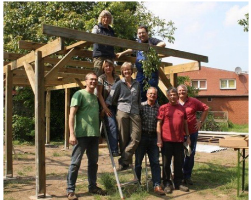
Mit Unterstützung der Stiftung Aufwind wurde ein „Carport“ für Boote und Trailer gebaut (2015)
